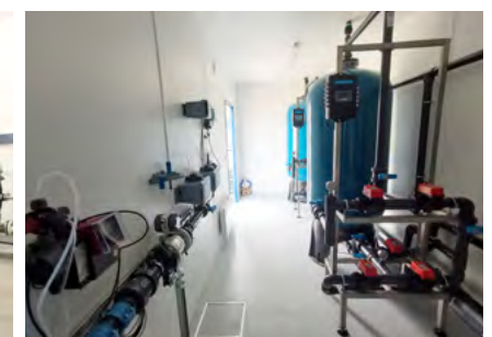
Kontejnerska izvedba peščene filtracije za pitno vodo, Đulovac (Hrvaška)
