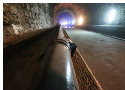
Hidrantno omrežje železniškega predora Karavanke (Slovenija)
