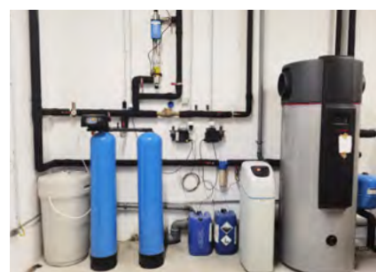
Sistem Victaulic za razvod tehnološke vode za ogrevanje in hlajenje v objektu Precision Resource (Slovenija)
