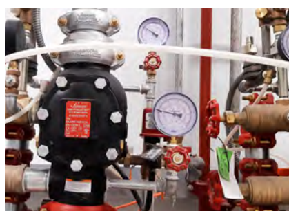
Sprinkler instalacije v Navigator Business Centru (Srbija)
