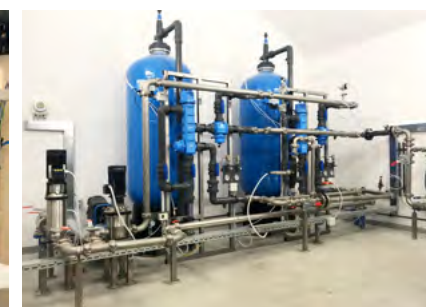
Peščena filtracija v čistilni napravi za pitno vodo v Podslivnici (Slovenija)
