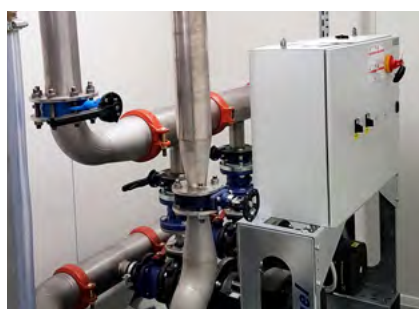
Razvod hlajenja tehnološke vode v TEM Čatež (Slovenija)
