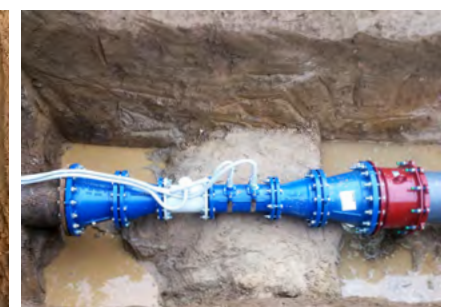
Merilno mesto za vodovodni sistem Ljubljana (Slovenija)
