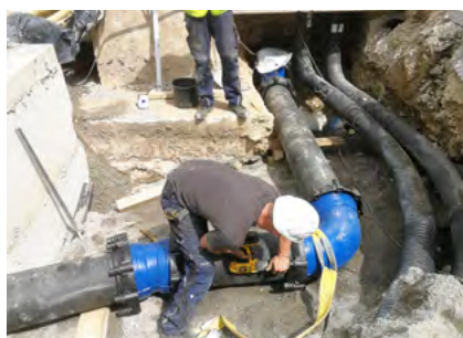
Duktilne cevi s FM certifikatom za povezavo sprinkler omrežja v BSH Nazarje (Slovenija)
