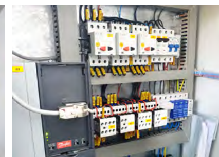
Postavitev sistema SCADA v WC-BIT 3 (Severna Makedonija)
