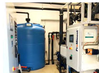
Ultra filtracija v čistilni napravi za pitno vodo, Vodarna Podstenjšek (Slovenija)
